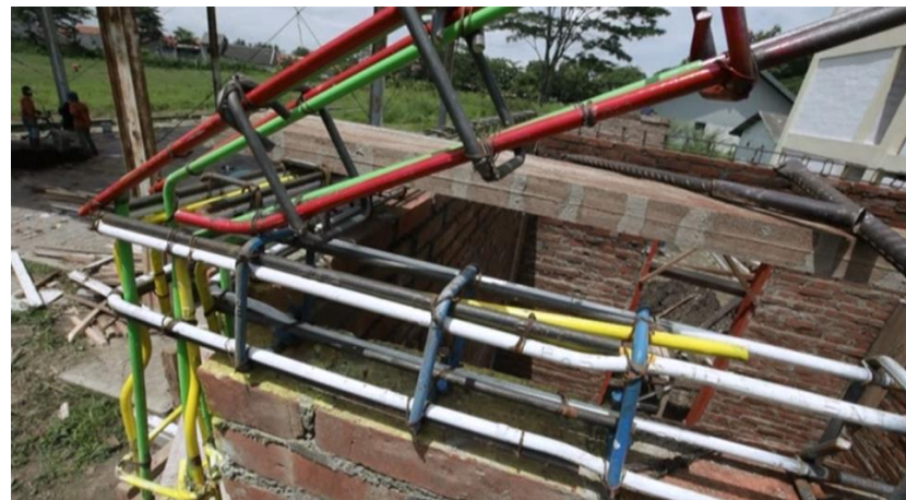
Gambar 53. Hubungan Antara Tulangan Bingkai Gunung-Gunung/ Ampig dengan Tulangan Kolom dan Balok Keliling/ Ring
